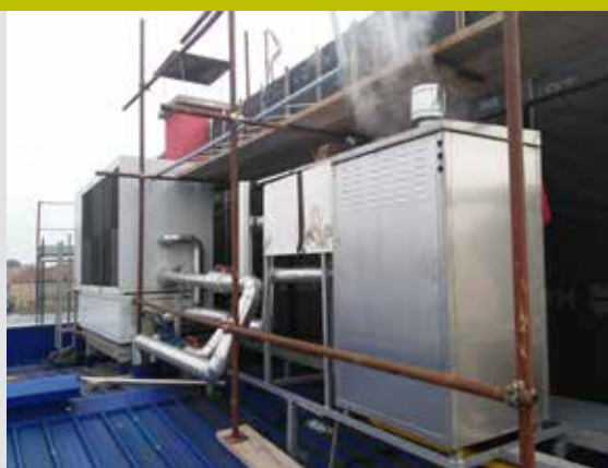
AB GRADNJA KARLOVAC MONTCOGIM PLINARA
